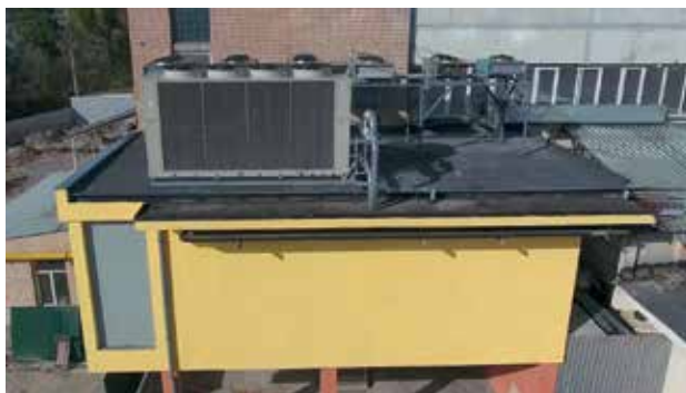
Рис. 1. Новый инженерный модуль дата-центра New Telco – внешний вид
