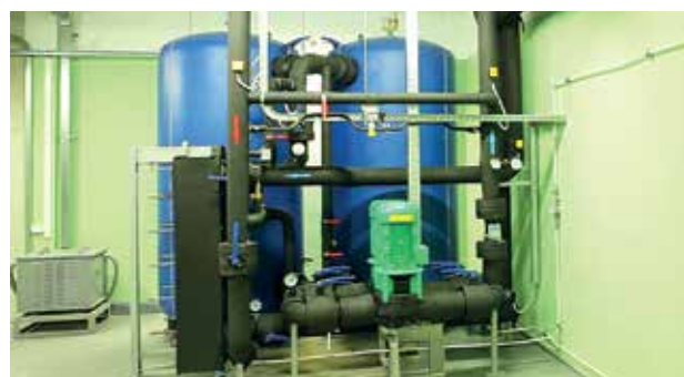
Рис. 2. Баки-аккумуляторы холода и часть системы распределения воды в новом гидромодуле New Telco
