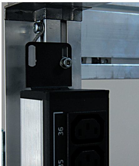
Блок распределения электропитания (PDU), закрепленный в специальных пазах шкафа Vertiv Knurr DCM
